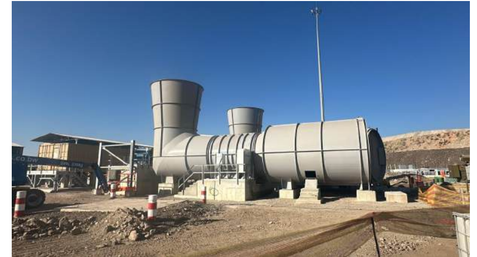
Main vent fan barrels and MCC
